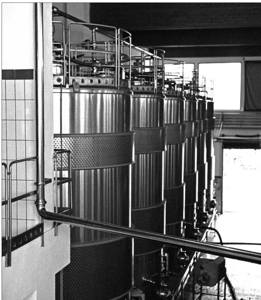
Nell'immagine, l'interno di una cantina sociale
